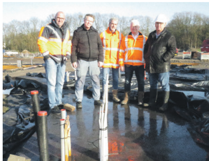
▲ Tevreden gezichten bij het aanschouwen van de eerste resultaten van de gestorte RAMAC-geopolymeervloer. Van links naar rechts: Patrick Ammerlaan (SQAPE), Ad Vlems (Ecodorp Boekel), Bert Büsgen en Han Heijsters (beiden A. Jansen BV) en Harry van der Kallen (ECO+BOUW).
